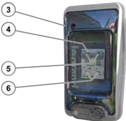
Figur 128: Kontrol af elektrisk 230V-stikkontakt på platformen 3
