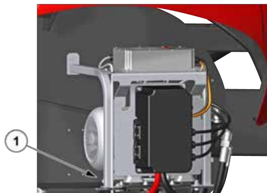
Figur 159: Kontrol af nødbetjeningsanordningerne fra platformen - første version
