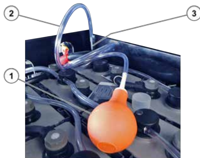
Figur 142: Tømning af højspændingsbatteriernes bakker
