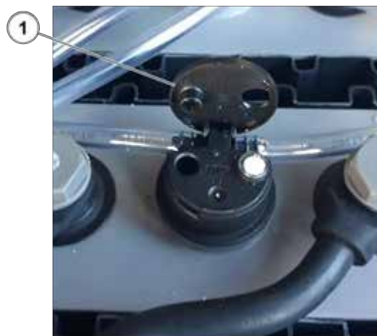
Figur 118: Kontrol af elektrolytdensiteten i højspændingsbatterierne
